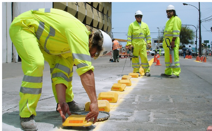
Uno de los aspectos más innovadores de esta iniciativa fue la instalación de 1.043 tachones reflectantes, utilizados para separar las vías segregadas.
